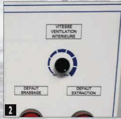
2 Fan speed controller
